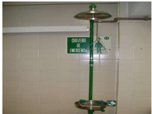
Chuveiro de emergência com lava-olhos
